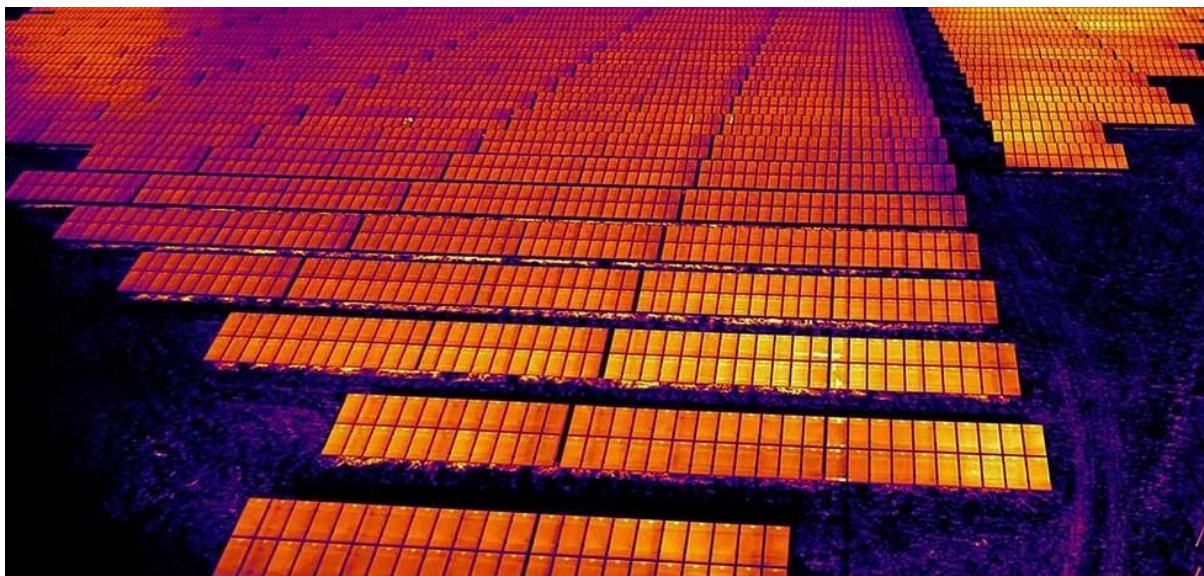
Imagem 2: Foto térmica de um sistema fotovoltaico.
